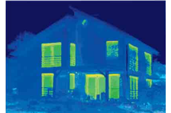
Nach dem sorgfältigen Einbau neuer Fenster aus dem Schüco LivIng Fenstersystem beweist die Thermografie den hohen energetischen Nutzen der Investition. Der ursprüngliche Energieverlust wird nahezu vollständig vermieden.
